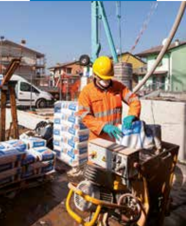
Příprava a čerpání směsi Novoplan Maxi s použitím čerpadla s kontinuální míchačkou
