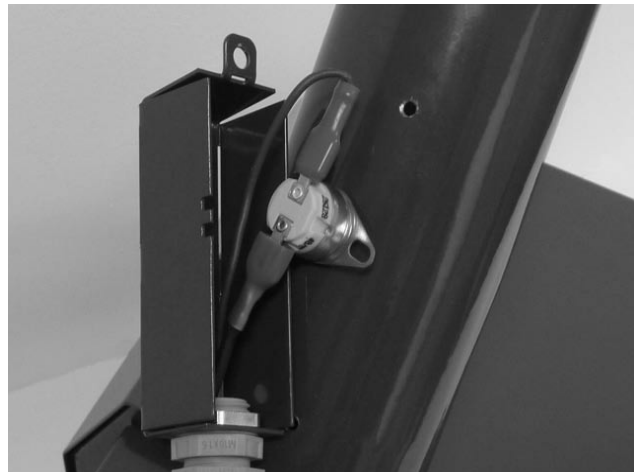
Obr. 10 - bezpečnostní termostat na trubce pro přívod pelet 95°C
