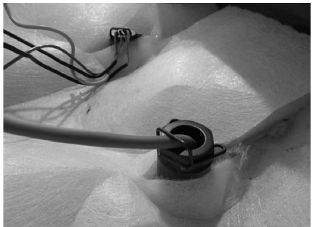
Obr. 16 - pohled na čidlo teploty vody TK v jímce kotle typ DxxP
