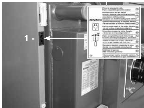
Konektor v pravé kapotě kotle
