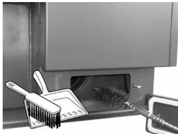
Ukázka čištění kouřového kanálu - spodní víčko
